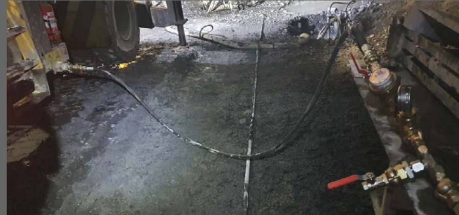
Utstyr for vanntapsmåling koblet til vann på boreriggen
