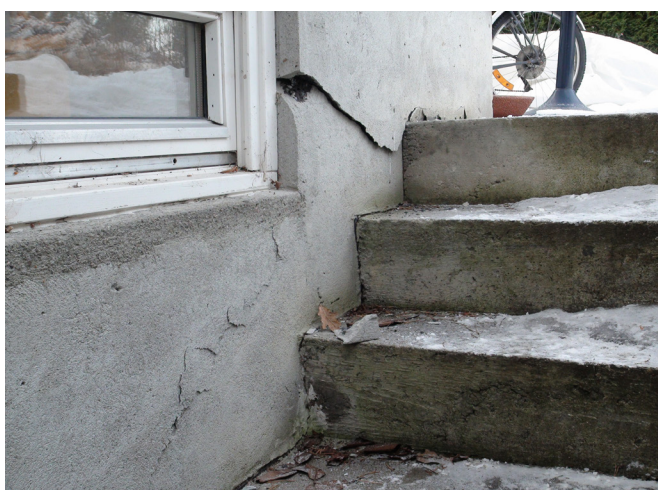
Sprengningsskade på bygning. Foto Multiconsult/Thor Watne
