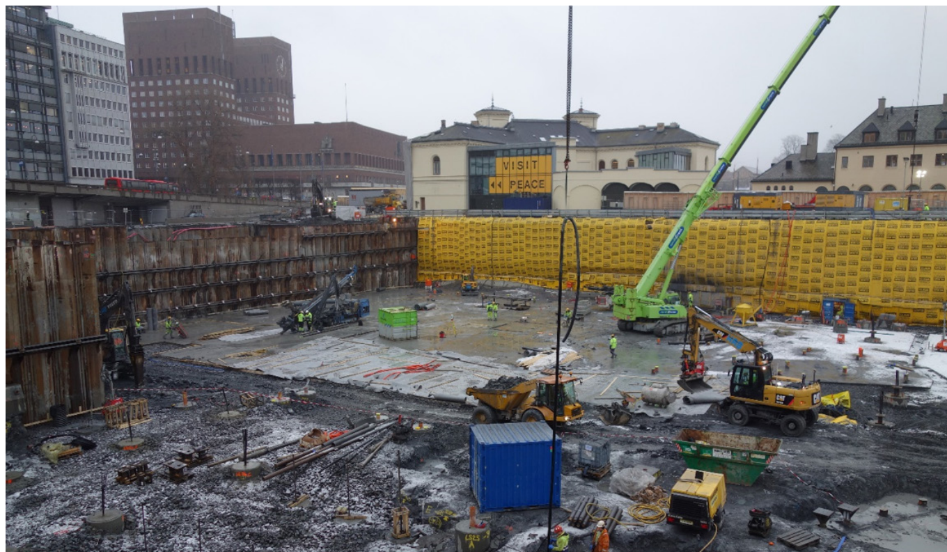
Bygegrop og fundamenteringsarbeider påvirker omgivelsene, avhengig av grunnforhold, byggemetoder og avbøtende tiltak
