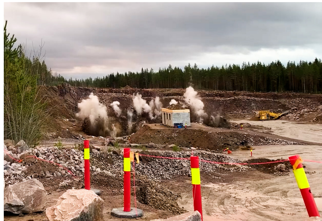
Sprengningsforsøk i Spjulsåsen steinbrudd i 2020. Testbygg i Leca blokker på fylling. Foto: NGI
