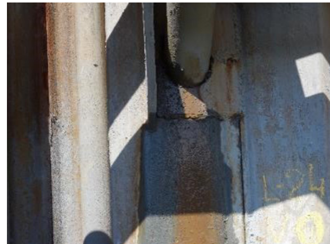
Figur 4: Lekkasje staggjennomføring utvendig svetting
