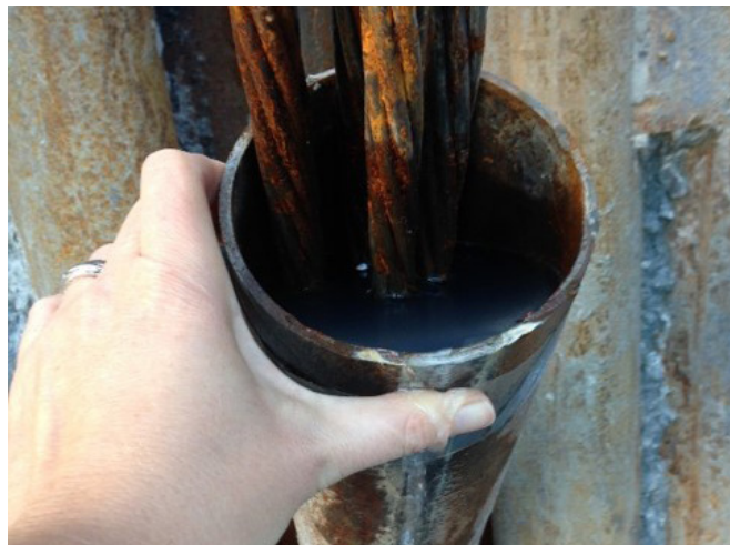
Figur 3: Lekkasje staggjennomføring innvendig
