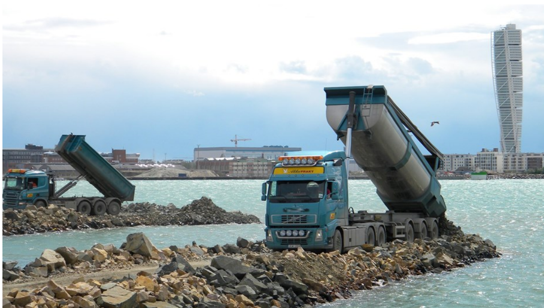
Figur 7.5. Innledende utfylling av sjetéer rundt Norra Hamnen i Malmö i 2008-2009 (Kilde: Skanska).
