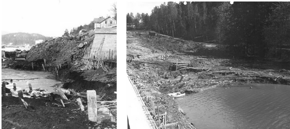
Figur 28. Utglidning ved E18 ved Mustadjordet i forbindelse med peleramming (bilde fra Statens vegvesen).
