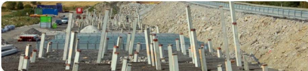
Figur 30 Betongpeler. Kilde: Kynningsrud: www.kynningsrud.no
