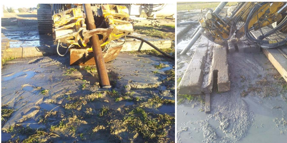
Figur 4-7: Til venstre; bilde av utspylt leirslam ved boring av foringsrør i leire og ca. 1,2 m inn i berg for stag C104. Til høyre; bilde av utspylt leirslam ved boring stag C105.
