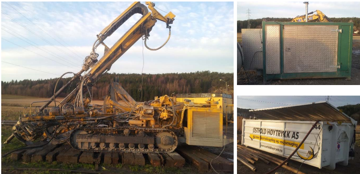
Figur 4-5: Til venstre; borerigg Klemm 803 klargjort for boring med vandrevet senkehammer i Felt C. Øverst til høyre; ekstern vannpumpe, nede til høyre; vanntank.
