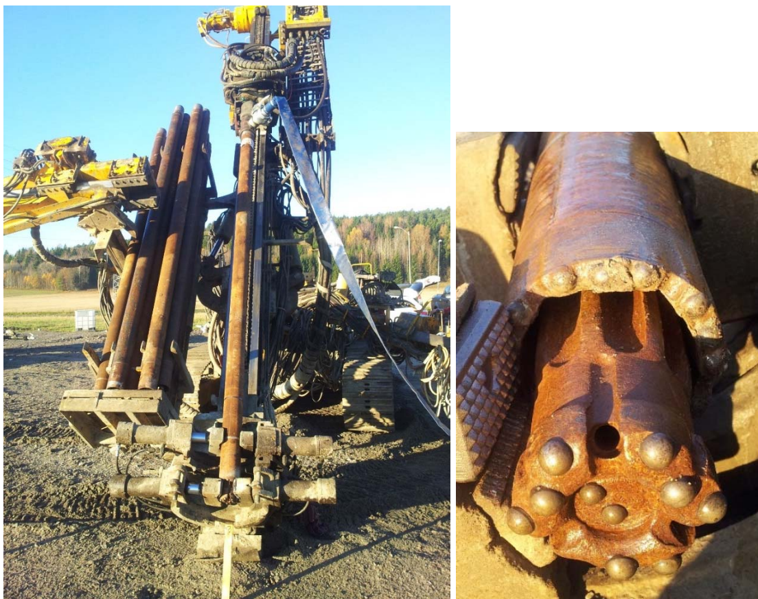
Figur 4-9: Til venstre; bilde av borelegg klargjort for boring av stag i Felt E. Påmontert slange for oppsamling av spylevann og borkaks. Til høyre; bilde av boresystem med ringborkrone og sentrisk fjellkrone.
