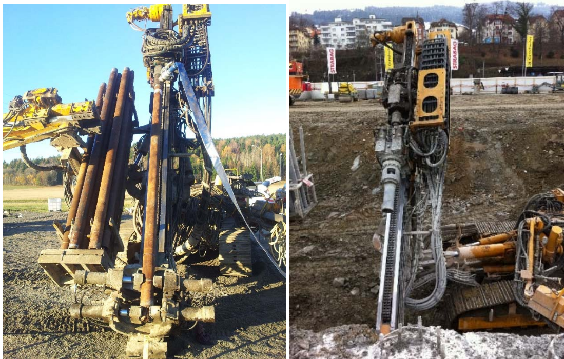
Figur 6-2: Til venstre, bilde av topphammerrigg med tykkvegget gjenga rør og sentrisk ringborkrone (OD 114) fra feltforsøk i Onsøy (Kilde: Einar John Lande). Til høyre, stagboring i Sveits med «double head» hammer og rotasjon (Kilde: Geir Veslegard).
